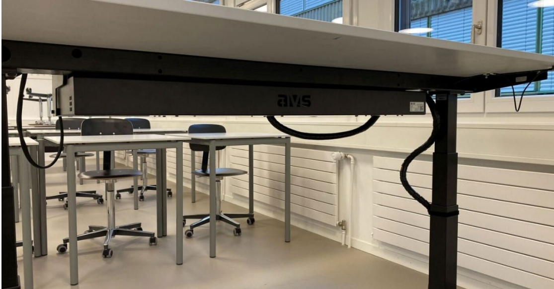
Bild: Arbeitstisch Medienzuleitung
